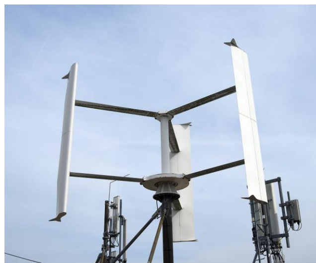
Rys. 6. Elektrownia wiatrowa o pionowej osi obrotu (VAWT) i mocy nominalnej 10 kW na dachu budynku F Wydziału Elektrycznego Politechniki Częstochowskiej
