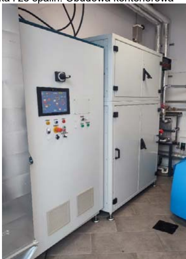
Rys.14. Kocioł indukcyjny w kotłowni
