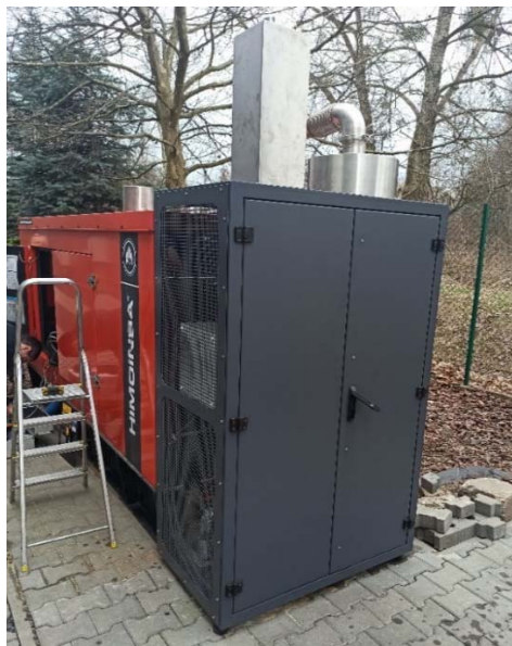
Rys.12. Zestaw odzyskiwania ciepła chłodzenia i ciepła spalin
