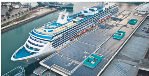
Rys.1. Instalacja fotowoltaiczna na nabrzeżu w Porcie w Los Angeles [15]
