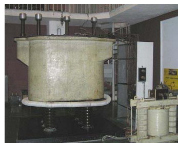
Rys. 7. Transformator TPZ 160 kV 300 kVA przerobiony z niemieckiego transformatora 200 kV z TH Breslau wykorzystywany w latach 1962-2014 [5]
