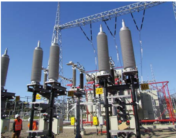
Rys.5. Widok zakończenia linii kablowych na terenie stacji elektroenergetycznej – linie kablowe systemu górnego
