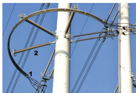
Rys. 7. Mostki prądowe (1) podtrzymywane izolatorami wsporczymi (2) w linii 400 kV [23]
