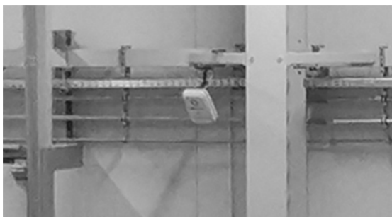
Rys. 2. Umieszczenie sensorów w hali
