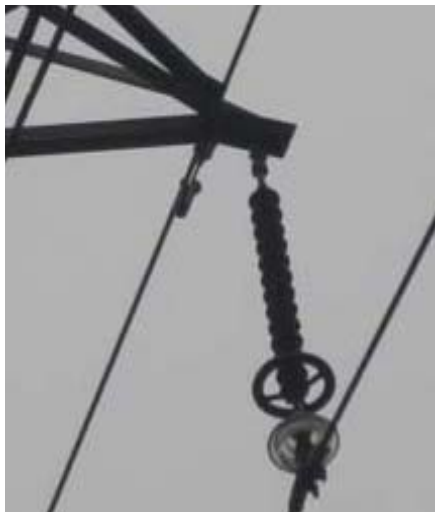
Rys.1. Wzmocniona izolacja linii 110 kV Shabao (Chiny) przez dodanie izolatora kołpakowego i pierścienia sterującego [12]
