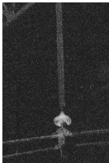
Rys.4. Fotografia izolatora PS120B z intensywnymi wyładowaniami powierzchniowymi
