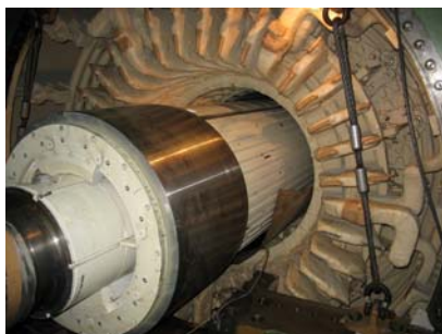
Rys.1. Przykładowy widok turbogeneratora 210MW w trakcie demontażu wirnika ze stojana, z widocznym kołpakiem
